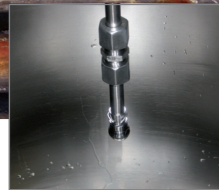
Abb. 4 a, b: Reinigungs- und Umwälzanlage für Rohrleitungen sowie Reinigungslanze mit Düse für Behälter
